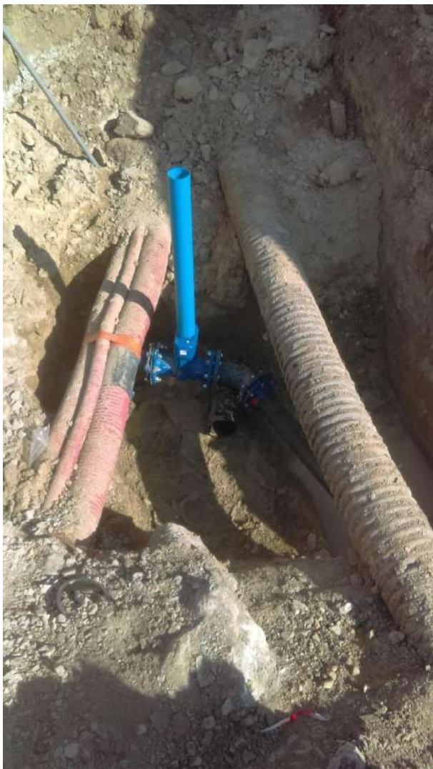
Raccord d'un maillage à St Mexant au milieu de gaines électriques, tuyaux eaux pluviales...
