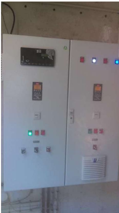
nouvelle armoire électrique
