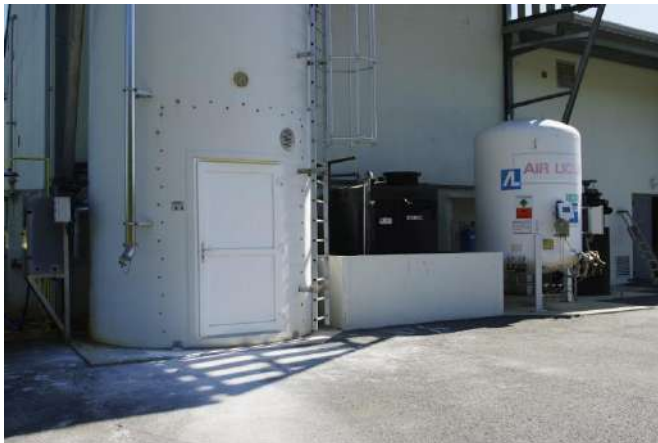
→ la station de traitement à St Mexant
