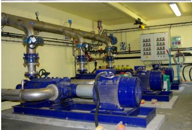
→ le local des pompes de refoulement
