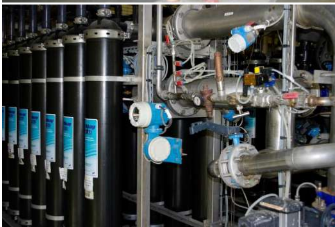
→ les membranes d'ultrafiltration
