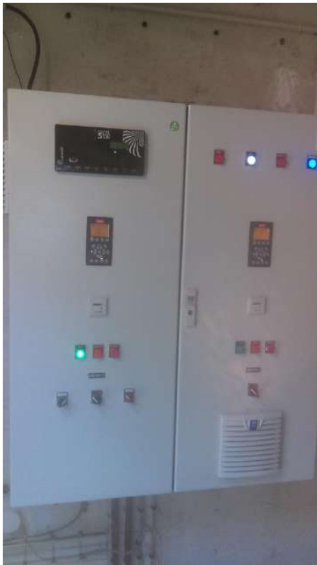
nouvelle armoire électrique
